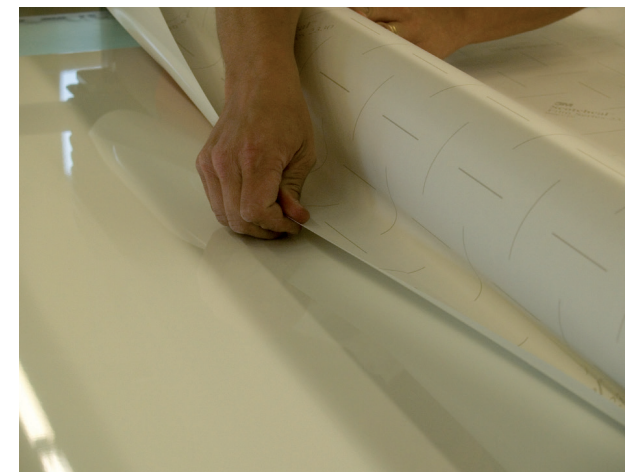
11. Prendere la parte di liner che in precedenza era stata piegata sotto il rullo...
